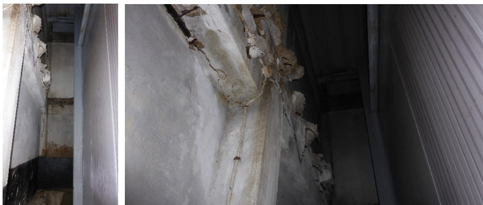
Photo mur entre panneaux sandwich et mur mitoyen
